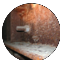
Roest en corrosie
